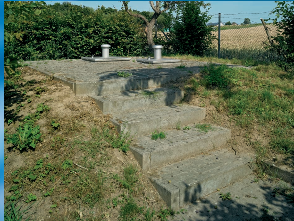
Abb. oben/links: Tiefbrunnen Freibad Obereisesheim
